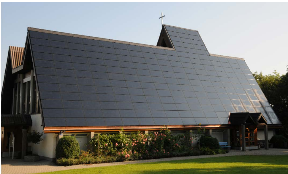
Saniertes Kirchendach mit integrierten polykristallinen Solarmodulen
