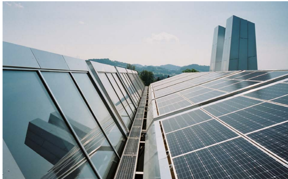
Eine der neuesten Fotovoltaikanlagen befindet sich auf dem Dach der Fernwärmezentrale Waldau im Quartier Lachen.
