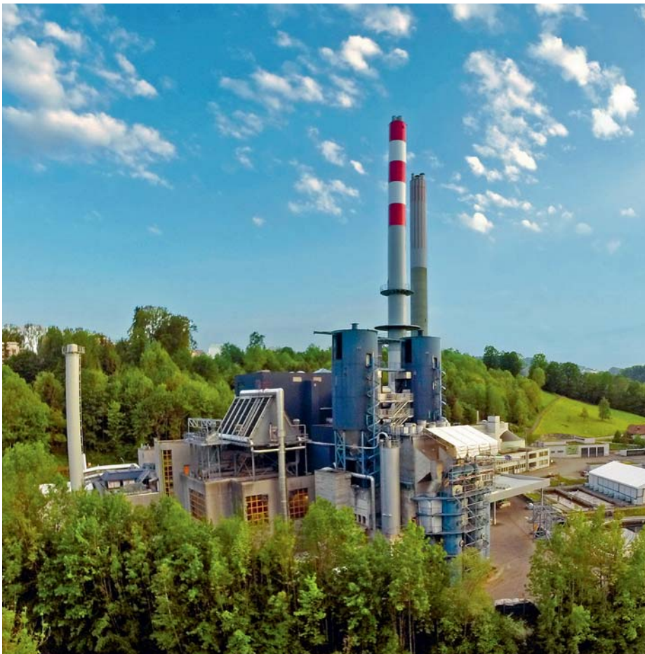
Kehricht-Heizkraftwerk: Mehr Energie für die Fernwärmeversorgung.
